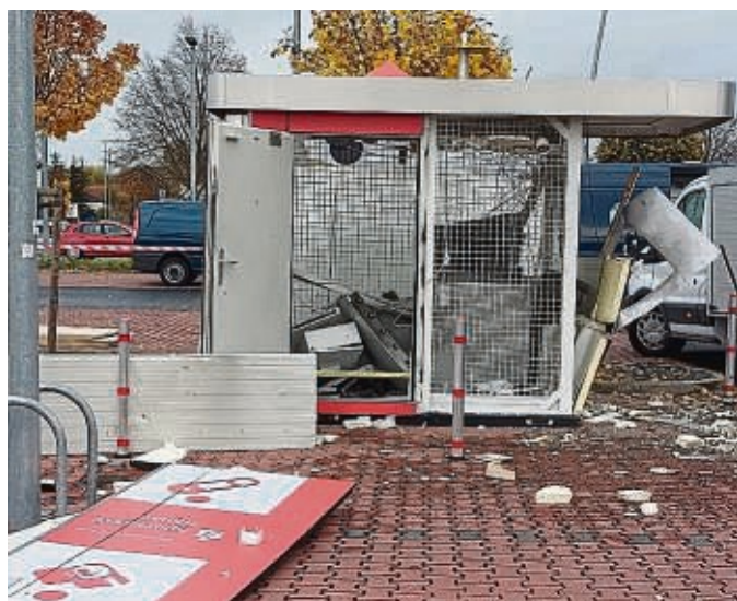
Geldautomat gesprengt: Bruchköbel ist Teil einer unheimlichen Serie von Anschlägen auf Geldautomaten in der Region. Im November fliegt der Automat beim Lidl in die Luft.
